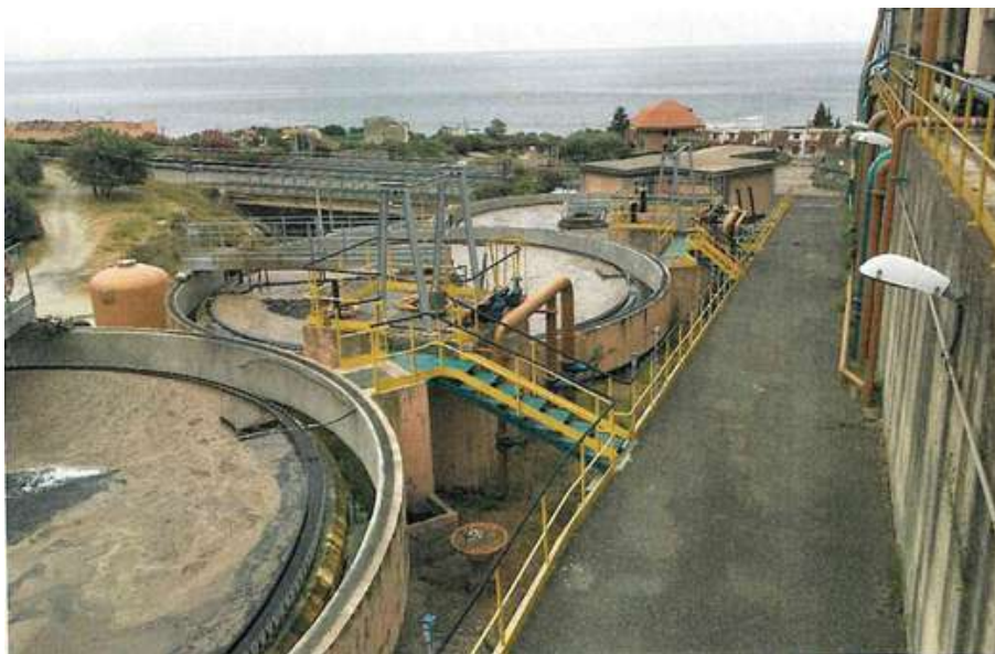
Impianto di Depurazione di Letojanni (ME) – Sedimentatori secondari
